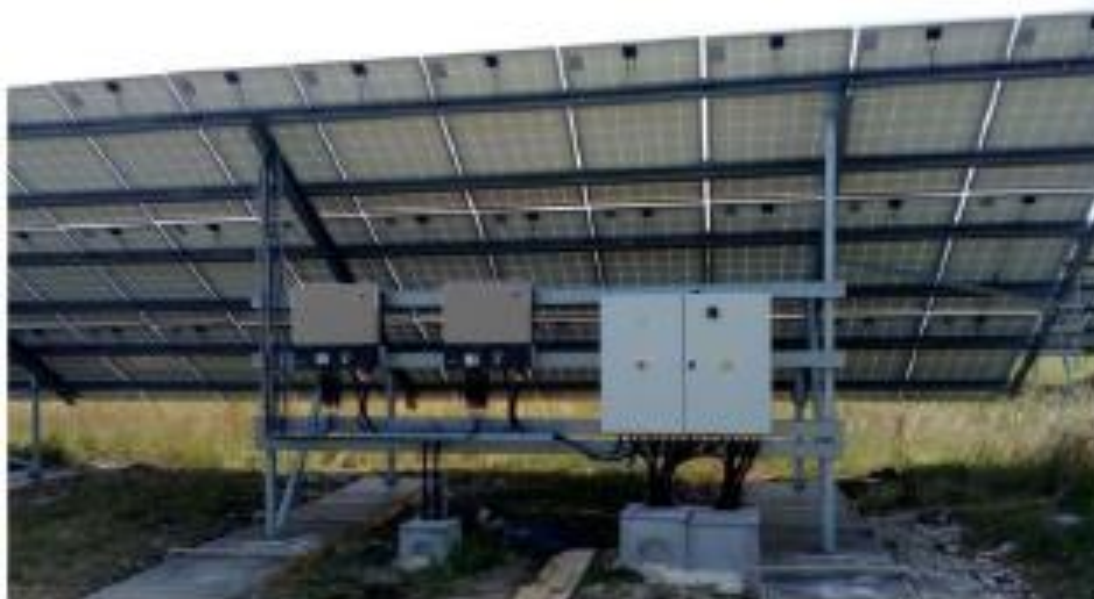
Onduleurs photovoltaïques fixés à la structure porteuse des modules
